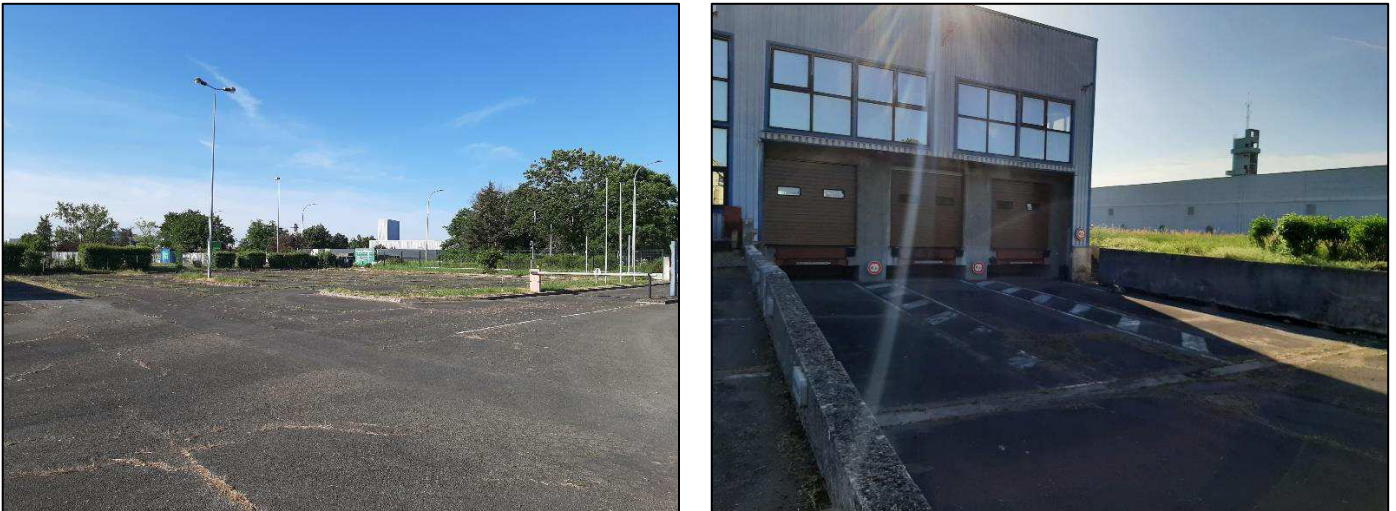
Figure 9 : Photographies du parking du site et de la zone des quais de chargement (source : Antea Group)
