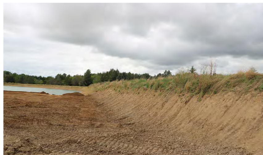
Modifications de l'occupation des sols : front de découverte sur la carrière actuelle engendrant des contrastes de couleur et de texture avec les surfaces agricoles environnantes
