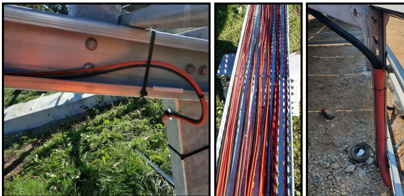
Figure 141 : Photographie d'une panne de structure, d'un fourreau sortant du sol, et d'un chemin de câbles non capoté (Source : SOLARVIA)
