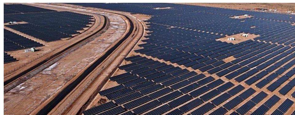
Centrale photovoltaïque au sol de Kamuthi, Inde
