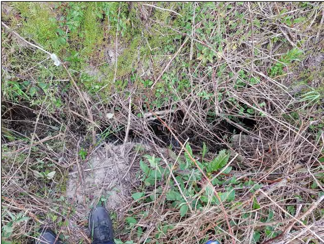
Figure 30 : Partie du passage busé abîmé en aval du bassin tampon.
