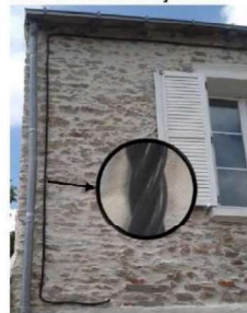
Réseau fils isolés façade BT
