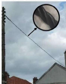
Réseau fils isolés aérien BT
