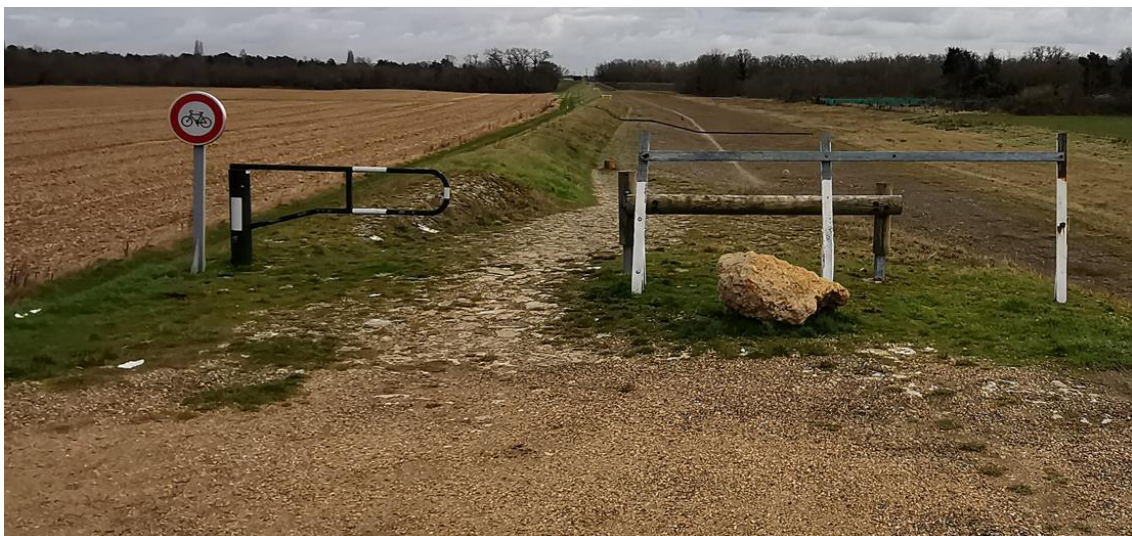
Figure 36 - Photographies du déversoir, présence de réseau en crête et marche et garde-corps métallique - photo du 22/01/2022 (Source : Antea Group)
