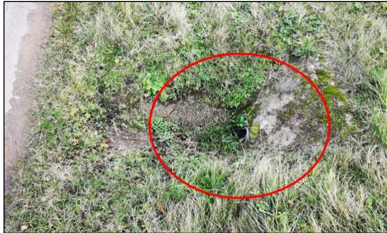
Figure 42 - Illustration de canalisations traversant la banquette côté val sur le secteur Guilly - photo du 22/01/2021 (Source : Antea Group)
