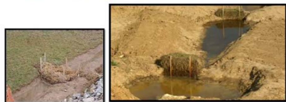
Filtre à paillet et bassin de décantation
