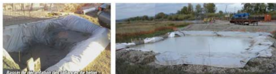
Bassin de décantation des laitances de béton
