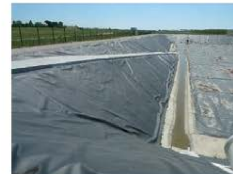
4 - Vue générale bassin BR3A
