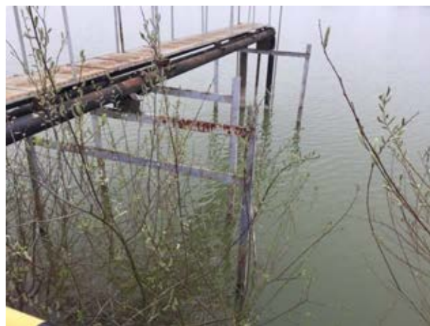
Photo 3 : Système de pompage des eaux de la lagune
