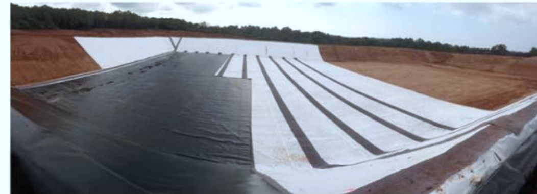
Installation d'une géomembrane dans un bassin de rétention d'eaux pluviales (Source : Afitex)
