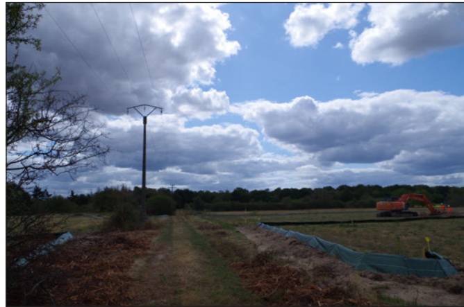
Ligne électrique aérienne
