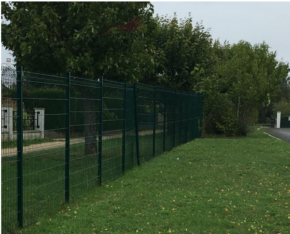
Photo 4 : Vue sur le grillage défectueux
