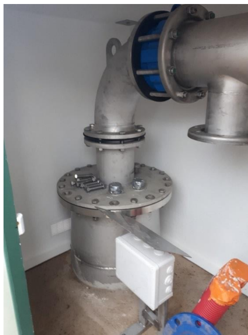
Tête de puits du forage F3
