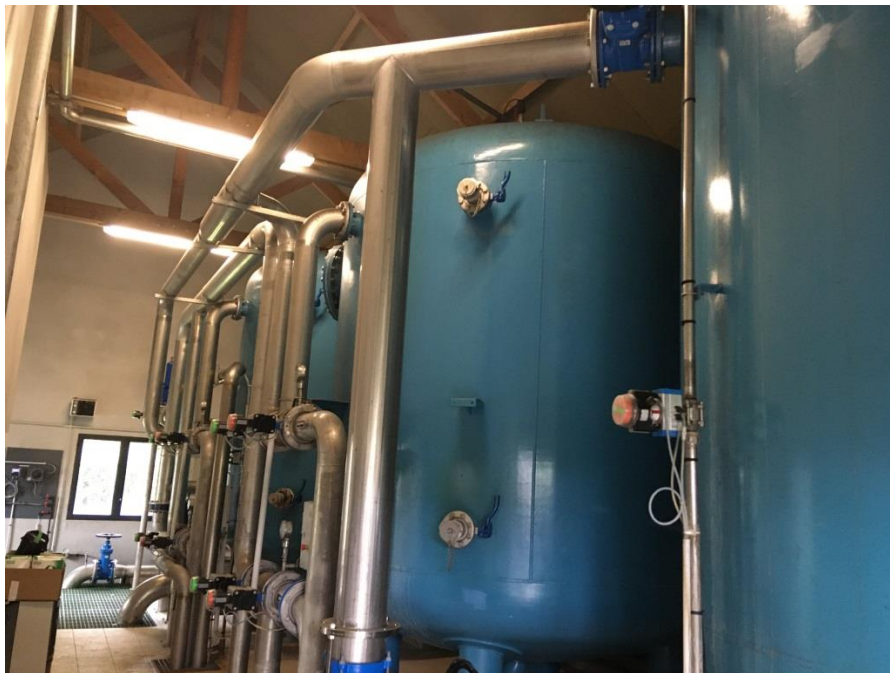
Photo 2 : Unité de traitement du fer et du manganèse
