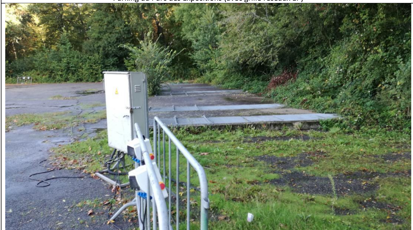
Fosse de décantation des EP du tramway et des quartiers à l'ouest
